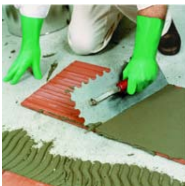
Pri bezdutinovom lepení sa vrstva malty naniesie aj na rubovú stranu dlažby.
